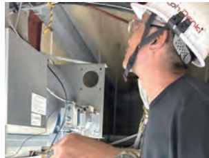
大型店舗改装の天井裏の配線
